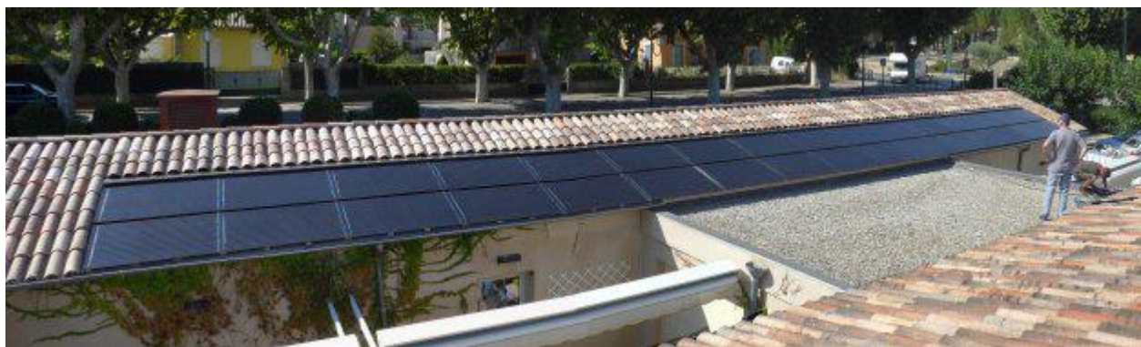
Photo : centrale photovoltaïque de la Crèche de La Tour d'Aigues
